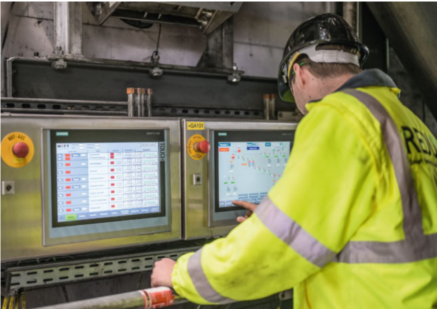
Über die SIMATIC HMI Panels können die Mitarbeitenden in der Produktion alle relevanten Parameter aufrufen.
