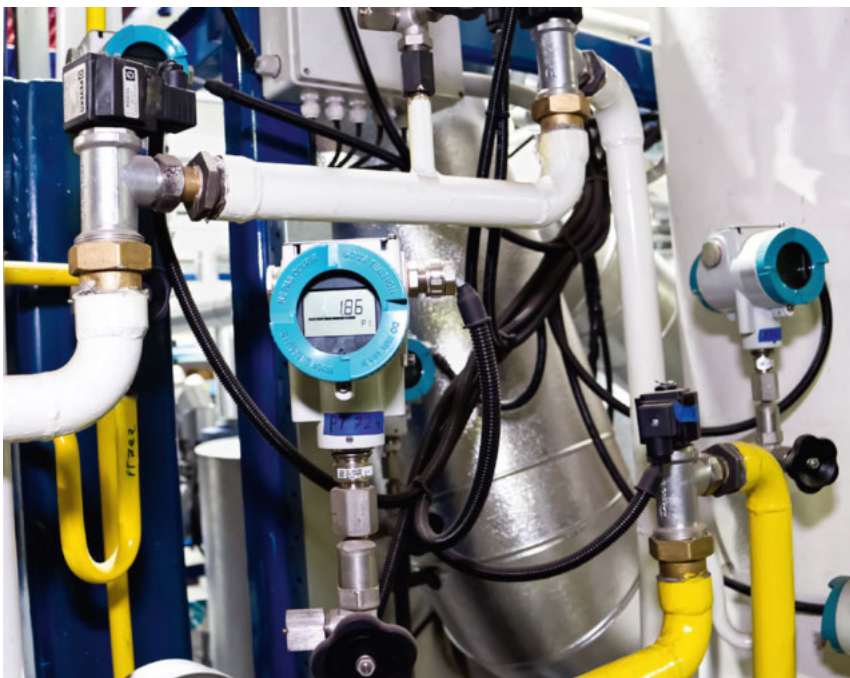
Die gesamte Recyclinglinie wird nicht nur von Siemens-Produkten gesteuert, auch andere Komponenten des Unternehmens kommen zum Einsatz.
